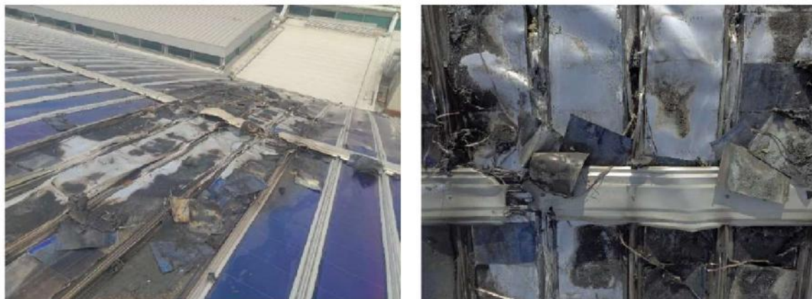
Dettaglio danneggiamento moduli fotovoltaici
