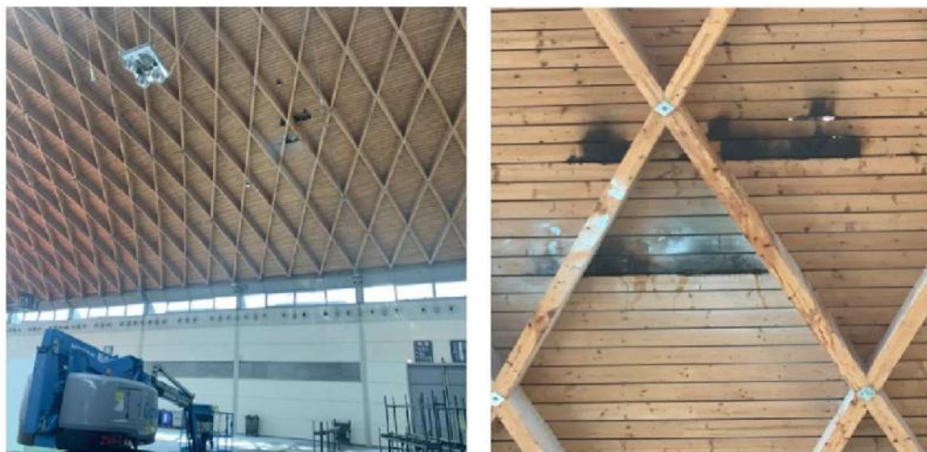
Dettaglio danneggiamento interno
